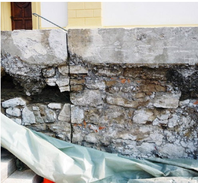
Obere Friedhofmauer (vorher)
